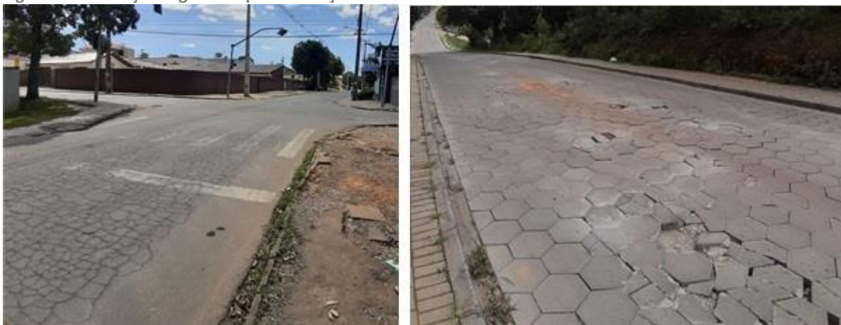
Figura 174: Situação regular da pavimentação na Rua Brasília Moura Leite e Rua Francisco Rocha
