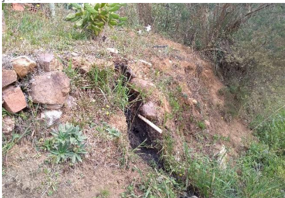
Figura 33: Tubo de pvc direcionando o esgoto para jusante.
