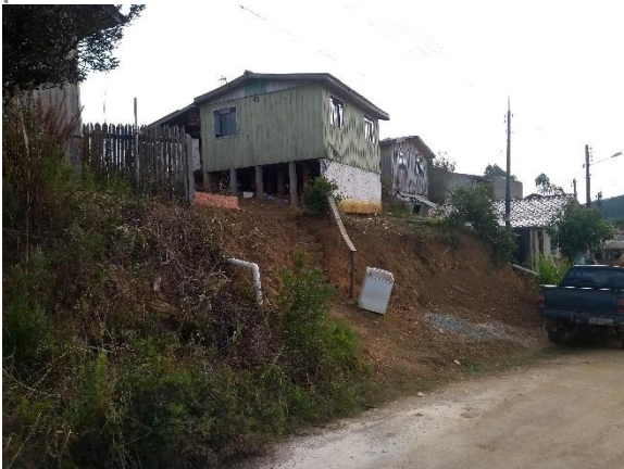
Figura 46: Corte de talude em ângulo sub-vertical próximo à Rua Ver. José Cavaliari.
