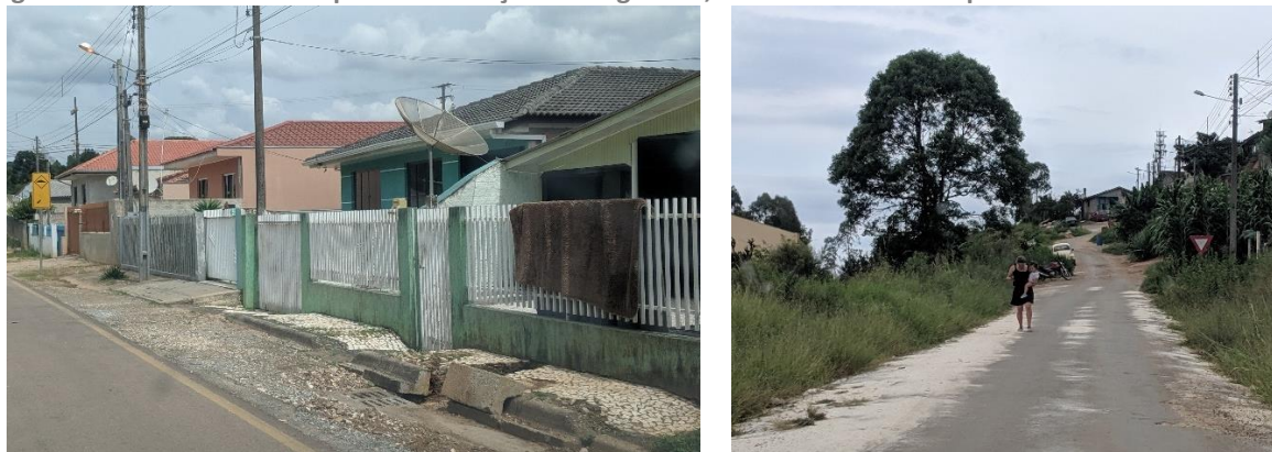
Figura 215: Inexistência de passeios e calçadas irregulares, causando riscos aos pedestres.
