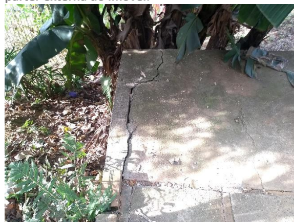
Figura 51: Piso de concreto com rachaduras na parter externa do imóvel.
