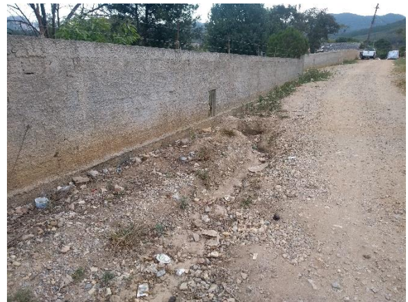
Figura 89: Materiais (solo/rocha) depósitos por eventos de enxurradas na estrada.
