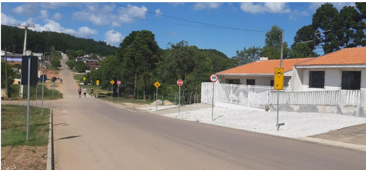
Figura 167: Indicação de lombada sem a presença de quebra-molas e excesso de placas na Rua Manoel Bassete Sobrinho
