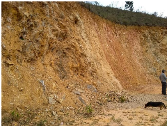
Figura 41: Material (solo/rocha) acumulado no sopé do talude.
