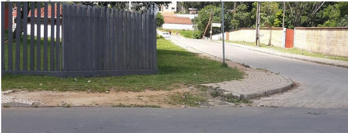
Figura 176: Calçada sem continuidade e em mau estado de conservação na Rua Francisco Rocha
