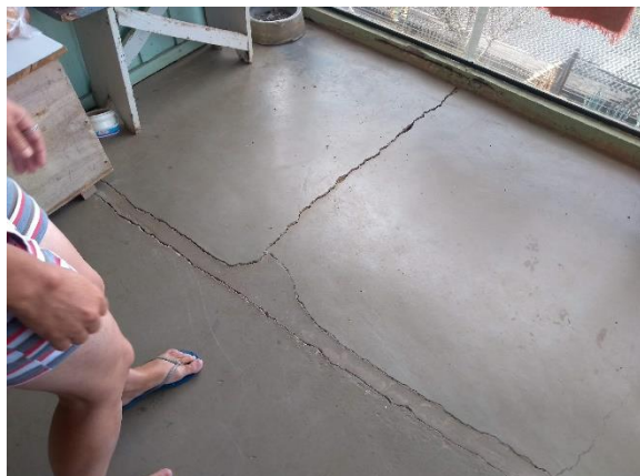
Figura 48: Piso com rachaduras no interior da residência.
