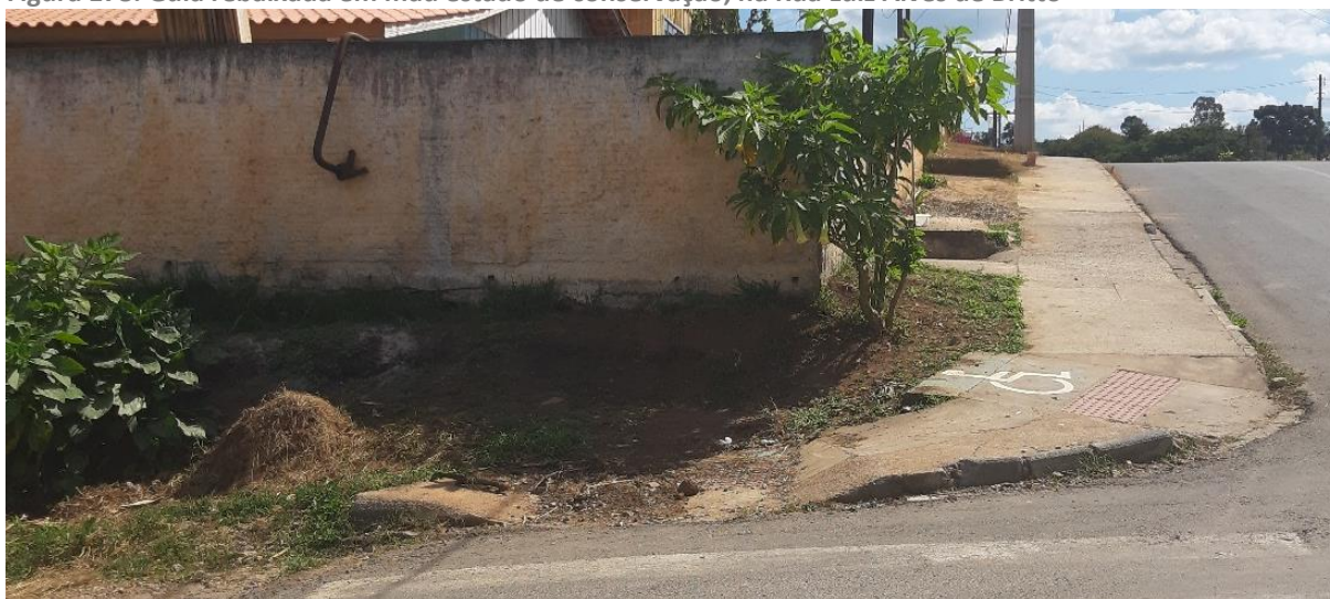
Figura 178: Guia rebaixada em mau estado de conservação, na Rua Luiz Alves de Britto
