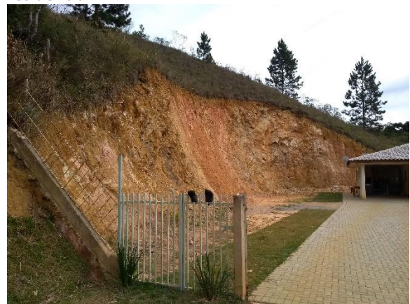
Figura 37: Corte de talude para ocupação residencial.
