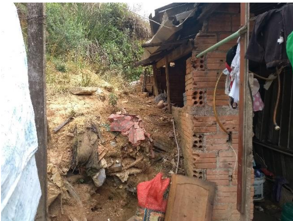
Figura 40: Edificação atingida junto ao corte de talude.
