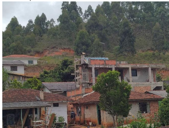
Novas construções em encosta, no bairro Boqueirão.
