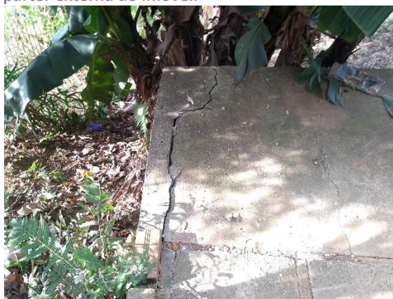
Figura 34: Piso de concreto com rachaduras na parter externa do imóvel.
