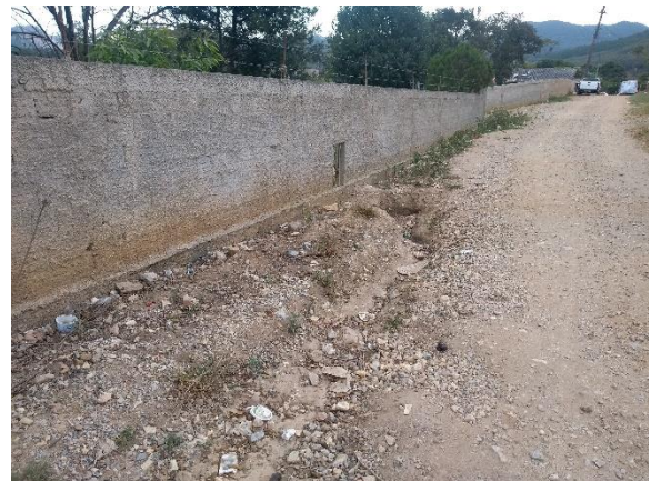
Figura 72: Materiais (solo/rocha) depósitos por eventos de enxurradas na estrada.
