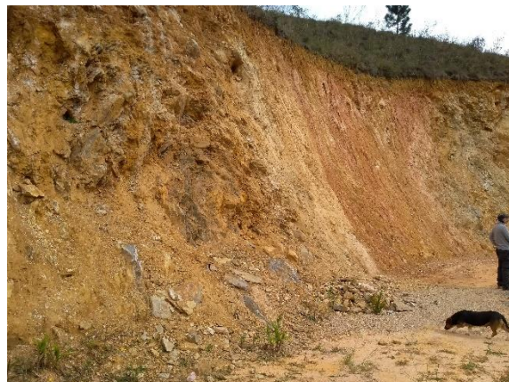
Figura 24: Material (solo/rocha) acumulado no sopé do talude.
