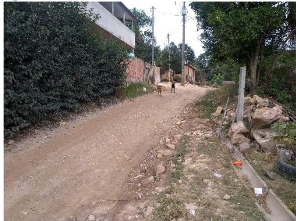
Figura 67: Rua sem asfalto no setor de risco avaliado.
