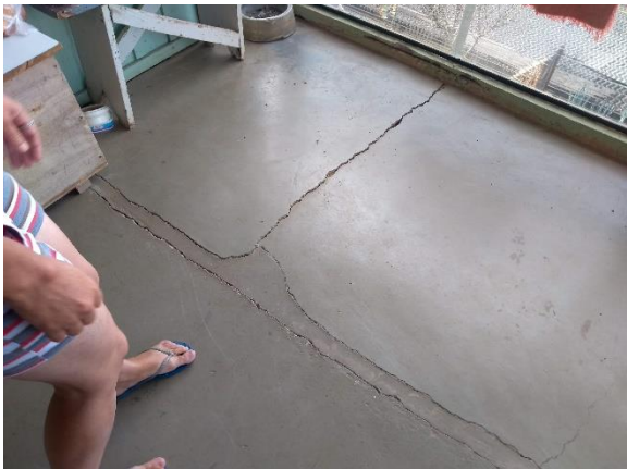
Figura 31: Piso com rachaduras no interior da residência.
