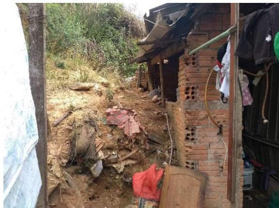
Figura 23: Edificação atingida junto ao corte de talude.
